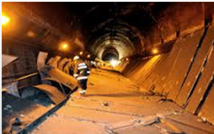
中央自動車道笹子トンネル天井崩落事故
