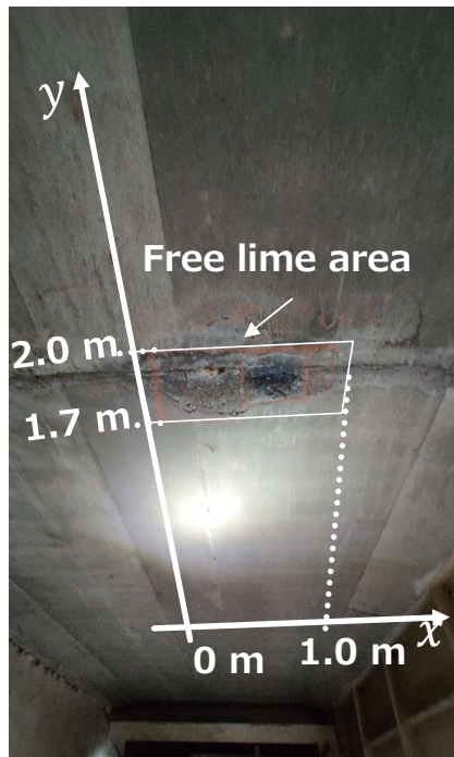
道路下面の遊離石灰箇所
